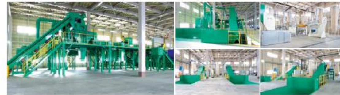
プラスチック再生施設
