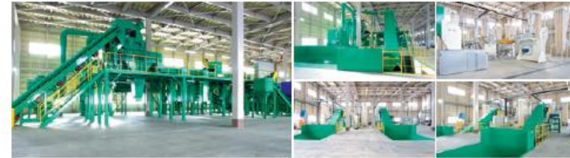
プラスチック再生施設
