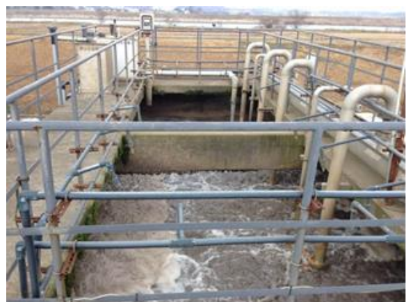
【工場排水処理設備】
