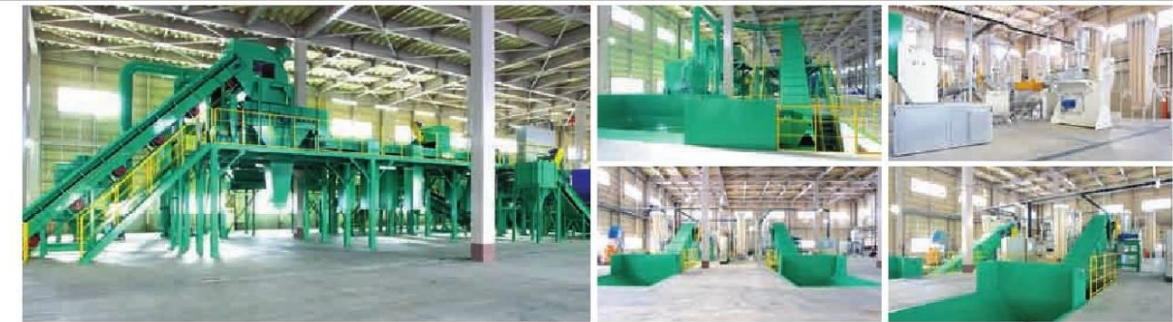
プラスチック再生施設
