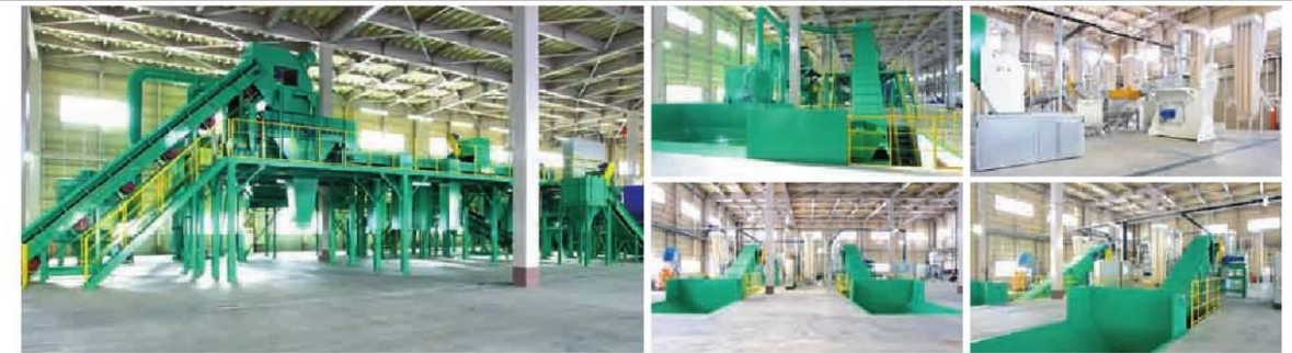
プラスチック再生施設
